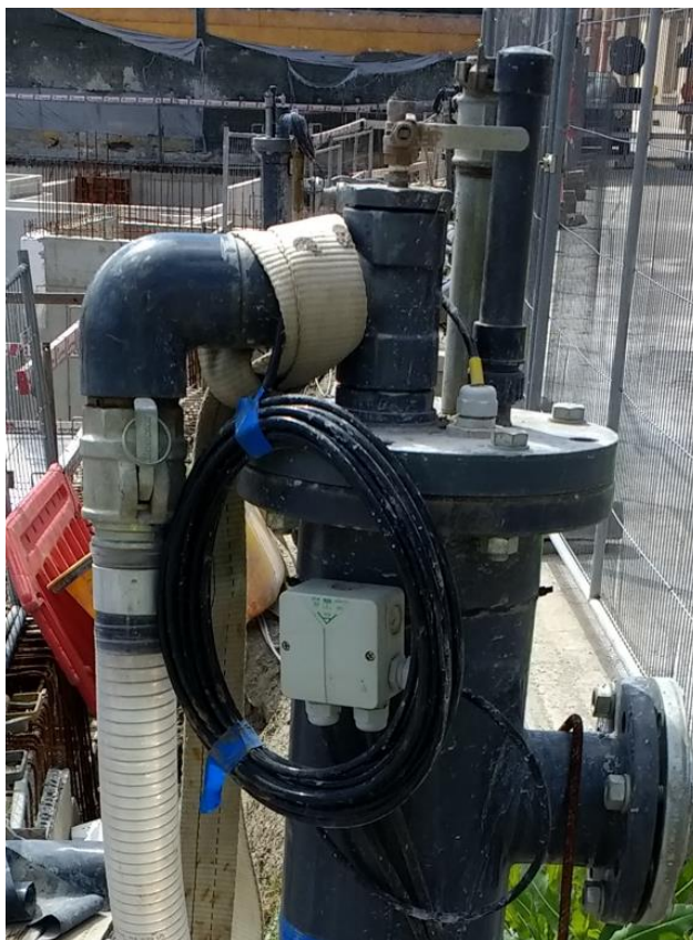
Detail van de kop van de retourbron met de invoerslang, de monitoringtoestellen, een ontlufter en een regeneratie buis
