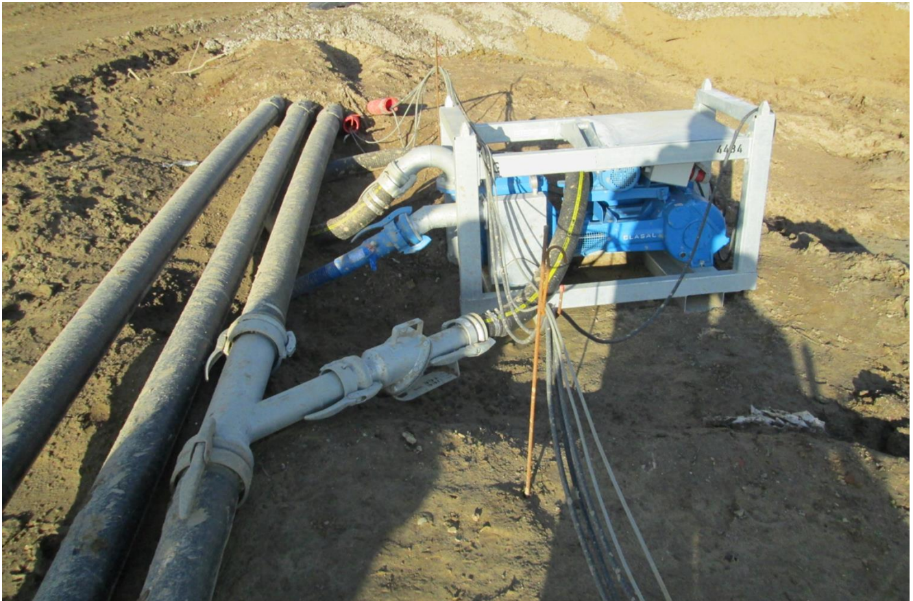
Blind gedeelte van de draineerbuis (blauwe buis) verbonden aan een zuigerpomp
