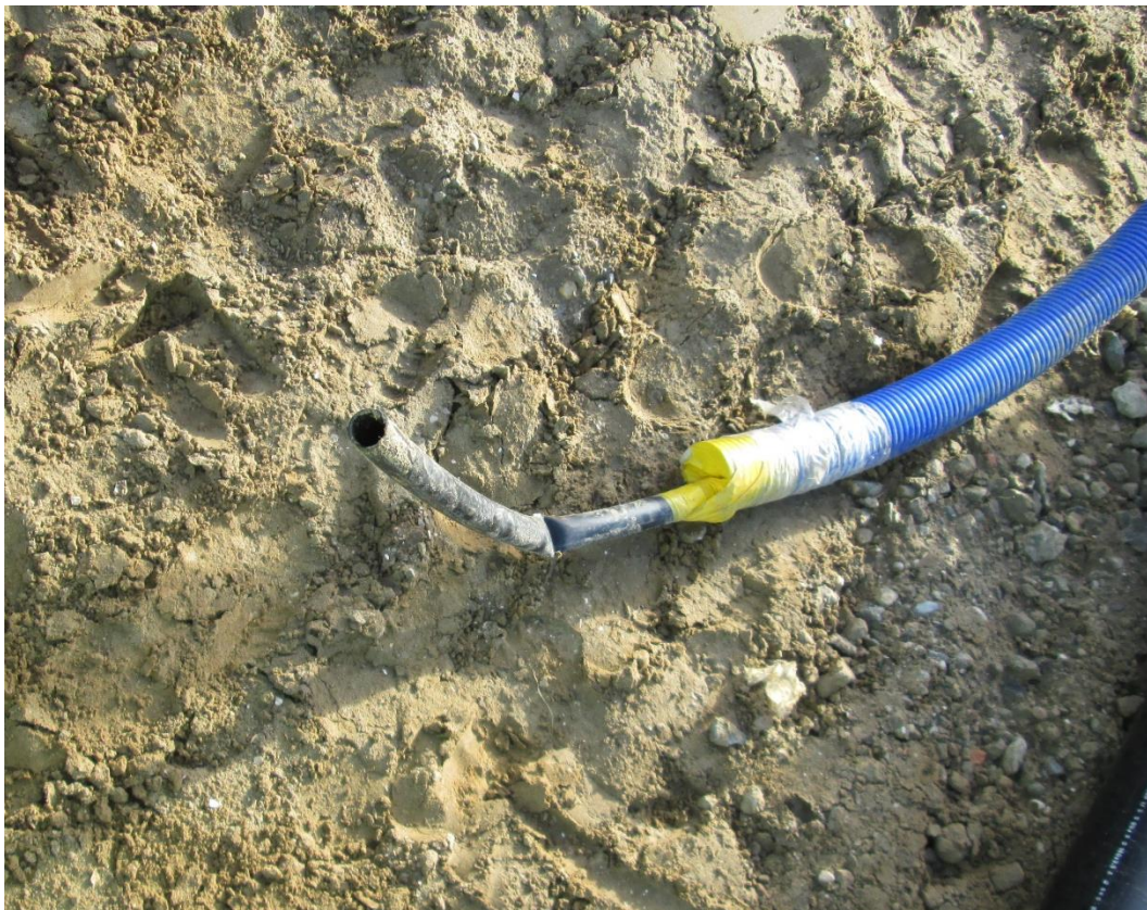
Injectiebuis - na afloop van de bemaling wordt de draineerbuis via het uiteinde opgegrout
