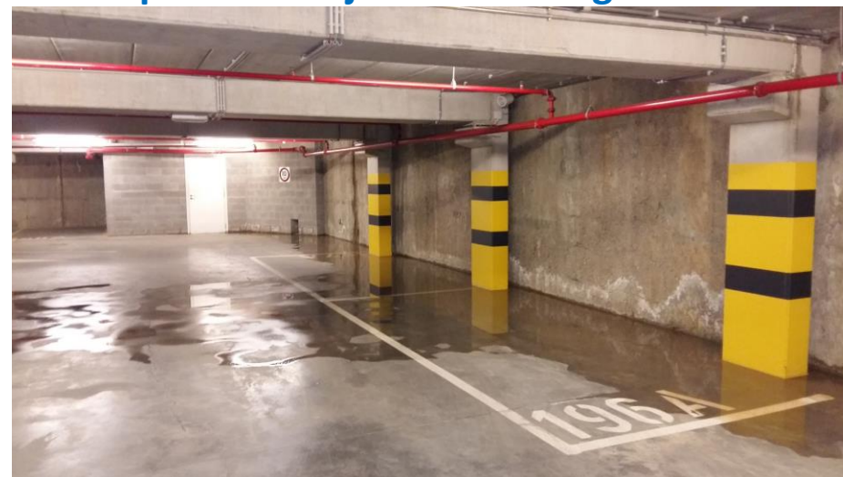
Diepwanden zijn niet volledig waterdicht
